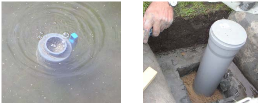
Abbildung 3-20: Öffnungen in der wasserseitigen Böschung des Deichs während des Einstaus bzw. während des Einbaus
